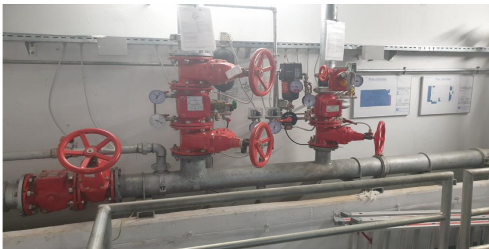
Sl. 13. Sprinkler stanica [10]
