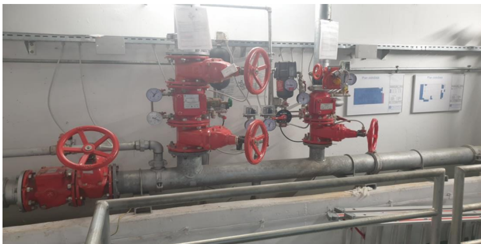
Sl. 13. Sprinkler stanica [10]
