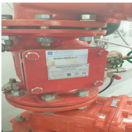
Sl. 16. Sprinkler ventil mokri [10]
