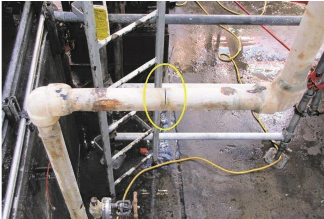
Slika 13: Fotografija cjevovoda povezanih s incidentom 10. ožujka 2014. godine. Žuti oval prikazuje rez koji su radnici napravili pomoću tračne pile što je rezultiralo oslobađanjem kiseline. Na slici 14 je prikazan i položaj ovog cjevovoda. [Proces safety culture case study Martinez, California, No. 2014-02-I-CA]
