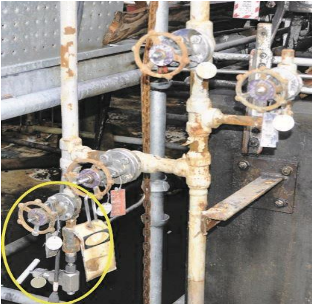
Slika 16: Fotografija odvodnih cjevovoda i ventila. Procjenom ove opreme nakon incidenta utvrđeno je začepljenje ovih cjevovodnih komponenti koje sprečavaju tekućinu da se slobodno odvodi kroz otvorene ventile. [Proces safety culture case study Martinez, California, No. 2014-02-I-CA]
