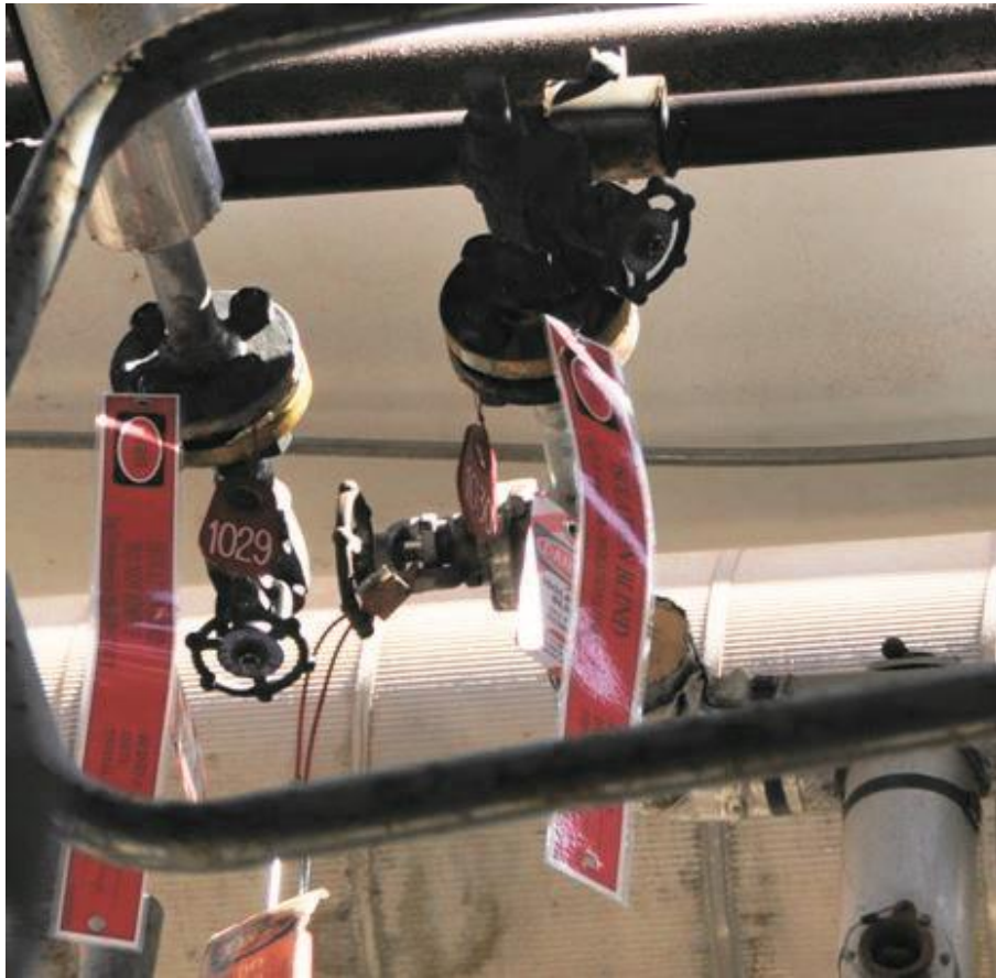
Slika 19: Fotografija izolacije cijevi za opskrbu tekućim butanom u reaktoru alkilacije poslije incidenta. Ova fotografija prikazuje isti cjevovod prikazan na desnoj fotografiji na slici 18. Tesoro je dva dana nakon incidenta u ožujku izmijenio izolaciju cijevi tekućeg butana kako bi odgovarao praksi preporučenog u API-ju, zahtjevima Tesorovih korporativnih standarda i preporukama postupaka Tesoro Martinez odvajanjem i instaliranjem izolacije prirubnice na svakom kraju izoliranog cjevovoda. [Proces safety culture case study Martinez, California, No. 2014-02-I-CA]
