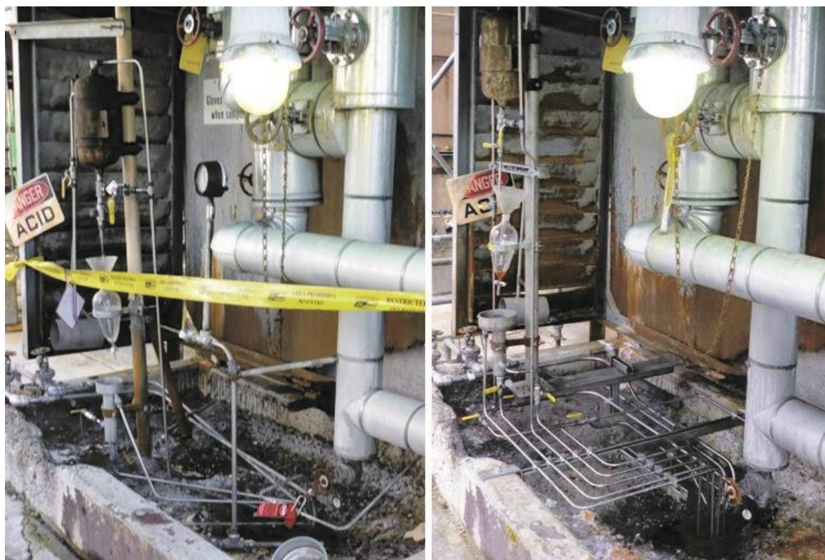
Slika 3: Fotografija prikazuje stanicu za uzorkovanje sumporne kiseline u rafineriji. Lijeva fotografija pokazuje uzorkovačku stanicu neposredno nakon incidenta 12. veljače 2014., a desna fotografija pokazuje stanicu nakon što su izvršeni popravci. [Proces safety culture case study Martinez, California, No. 2014-02-I-CA]
