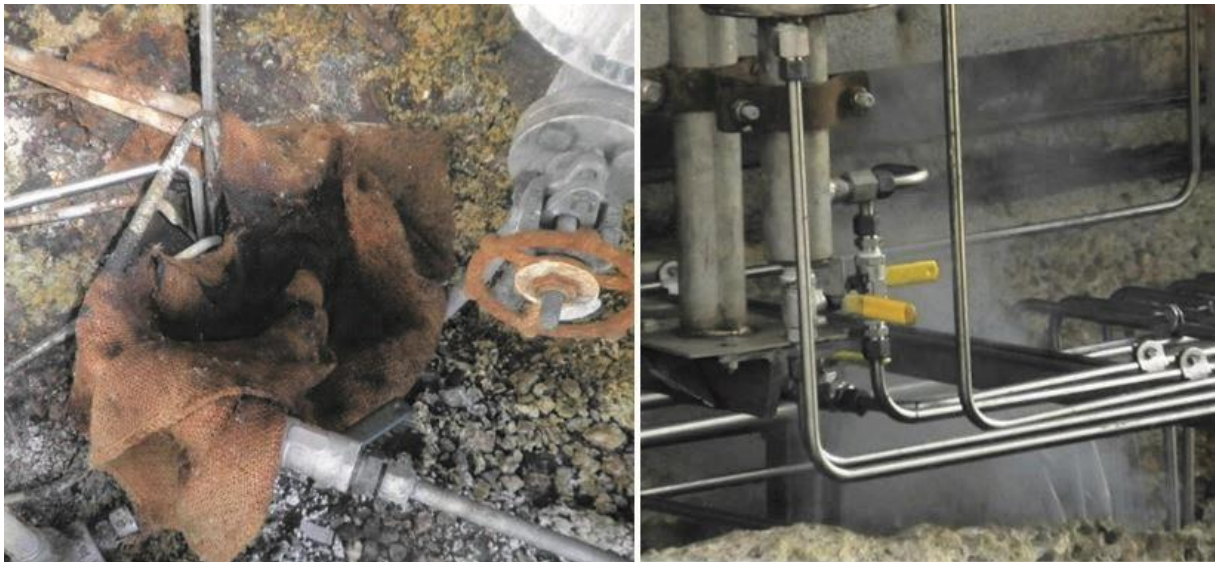
Slika 5: Fotografija s lijeve strane prikazuje vreću s protupožarnim pokrivačem koja pokriva procesni odvod kanalizacije na jednoj od stanica uzoraka sumporne kiseline u rafineriji Tesoro Martinez. Fotografija desno prikazuje oblak bijele pare koji se oslobađa iz procesne odvodnje kad Tesorovi operatori provode postupak uzorkovanje sumporne kiseline. [Proces safety culture case study Martinez, California, No. 2014-02-I-CA]
