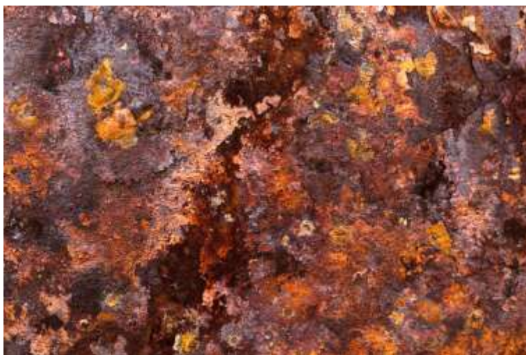
Slika 4. Korozija čelika (Anonymus, 2017.)
