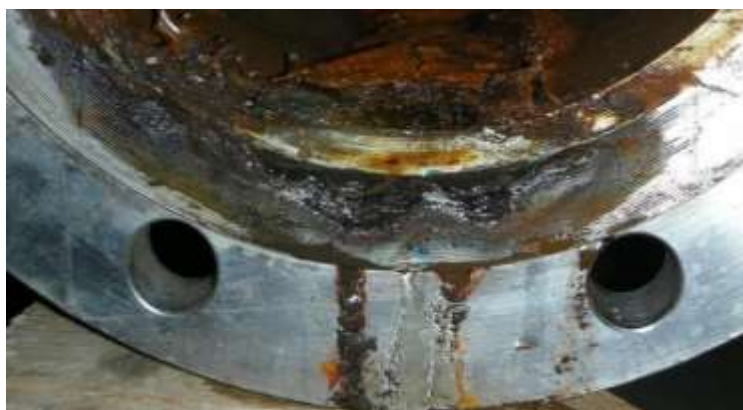
Slika 12. Korozija uzrokovana staništem mikroorganizama (Alar, 2015.)
