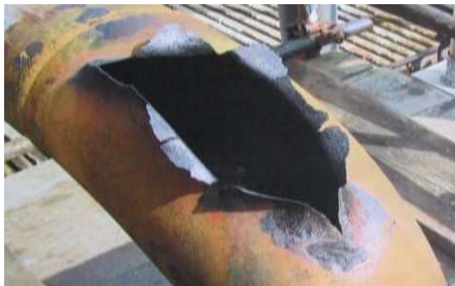
Slika 14. Oštećenje na cjevovodu uzrokovano erozijskom korozijom (Alar, 2015.)
