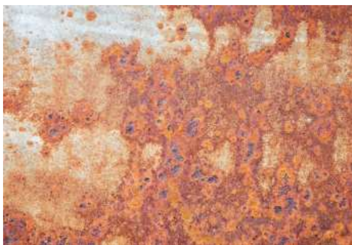
Slika 6. Ravnomjerna korozija na čeliku (Anonymus, 2017.)
