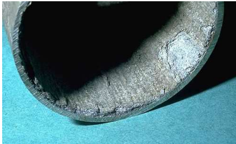
Slika 15. Selektivna korozija (INSA, 2017.)
