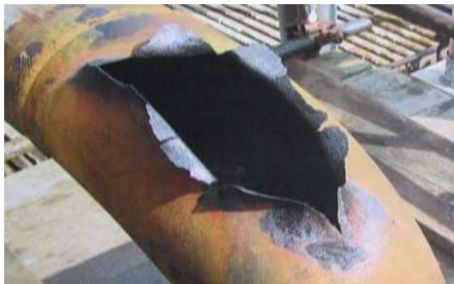
Slika 14. Oštećenje na cjevovodu uzrokovano erozijskom korozijom (Alar, 2015.)
