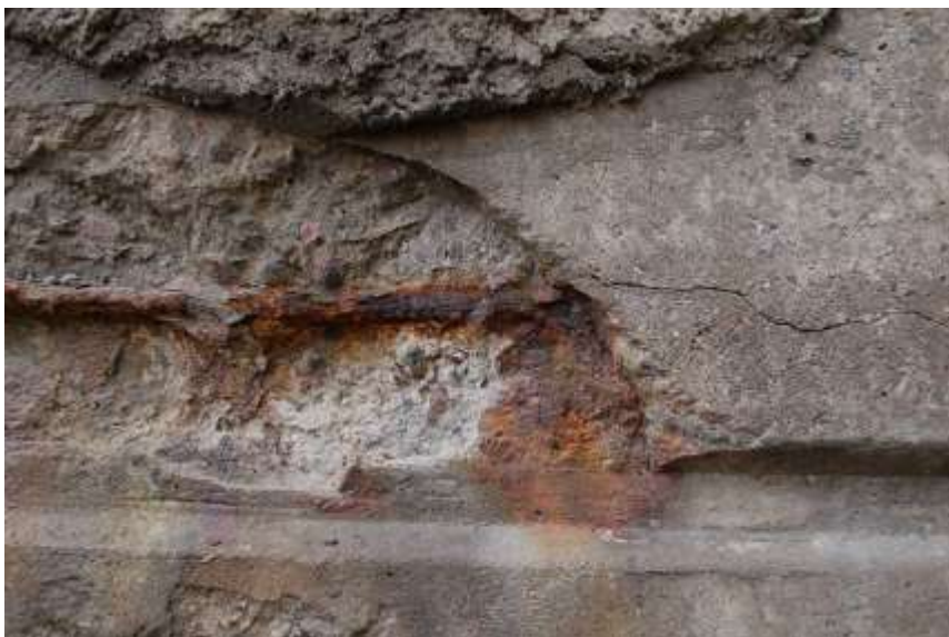
Slika 5. Korozija armature u betonu (De Carufel, 2018.)
