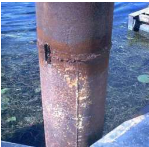
Slika 7. Korozija cjevovoda u vodenom okolišu (Alhaboubi, 2014.)
