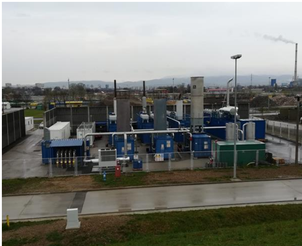
Slika 10. postrojenje za gospodarenje plinom
