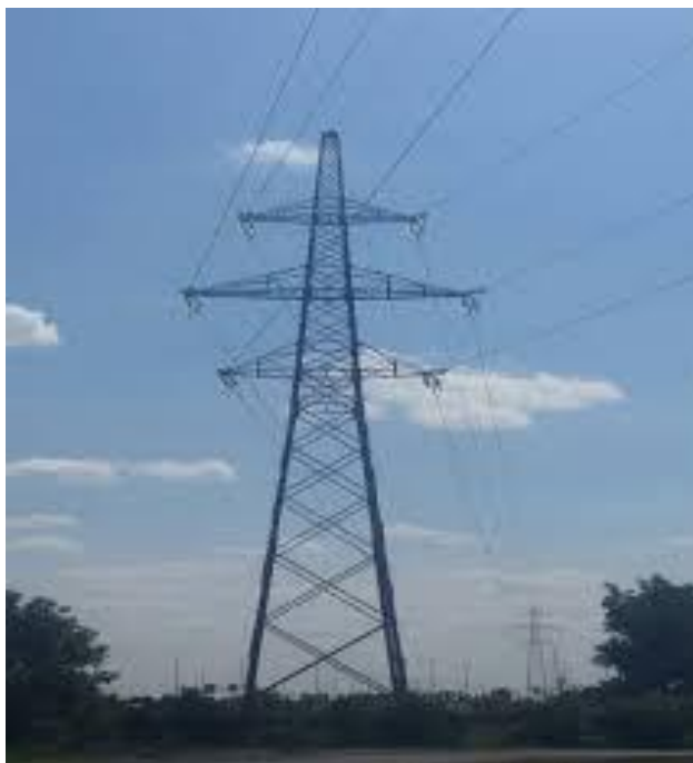
Slika.2.1. jednostruko čelično-rešetkasti stup "jela"
