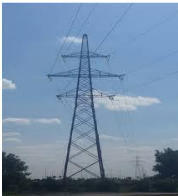
Slika.2.1. jednostruko čelično-rešetkasti stup "jela"
