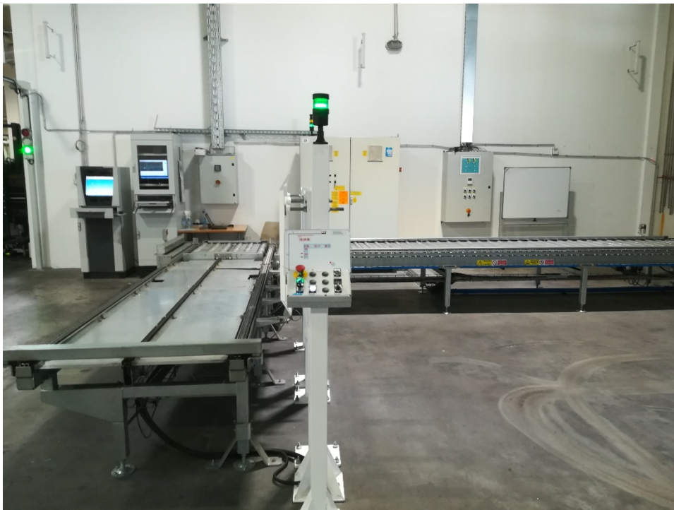
Slika 14. Prikaz postavljene instalacije, instalacijskih ormara i pultova.
