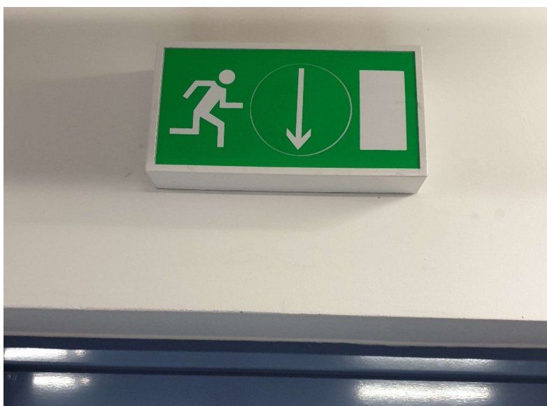
Slika 13. Protupanična rasvjeta sa pripadajućim piktogramom u novoj upravnoj zgradi HEP-a [13]
