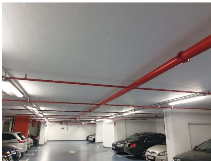
Slika 10. Automatske sprinkler instalacije u garaži HEP-a [13]
