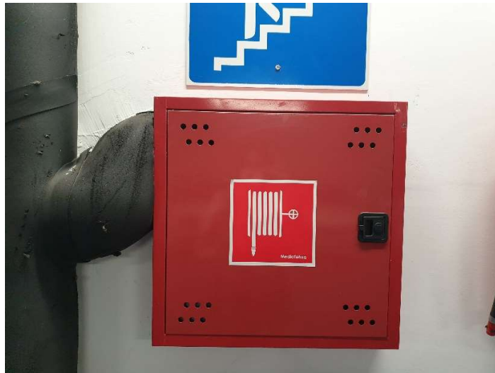
Slika 14. Unutarnji hidrant priključen na hidrantsku mrežu u garaži HEP-a [13]
