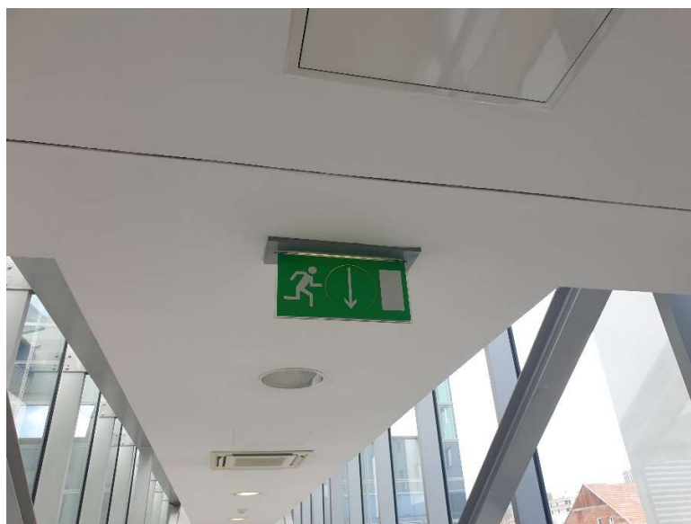
Slika 12. Protupanična rasvjeta sa pripadajućim piktogramom u novoj upravnoj zgradi HEP-a [13]
