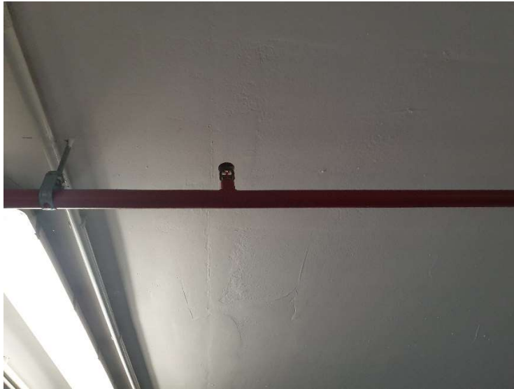
Slika 11. Automatske sprinkler instalacije u garaži HEP-a [13]
