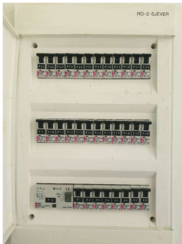
Slika 17. Razvodni ormarić na drugom katu zgrade „Institut“ [13]
