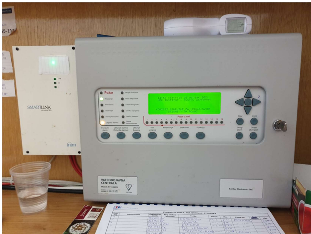
Slika 9. Vatrodjavna centrala na recepciji zgrade 'Instituta' [13]
