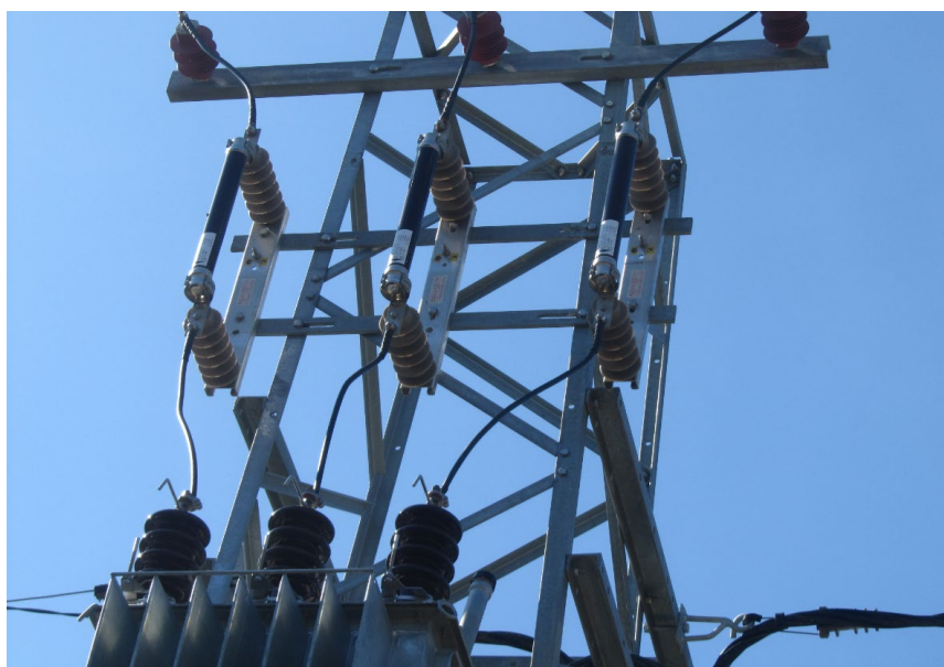
Slika 4 Prikaz dolaza viskog napona na trafostanicu
