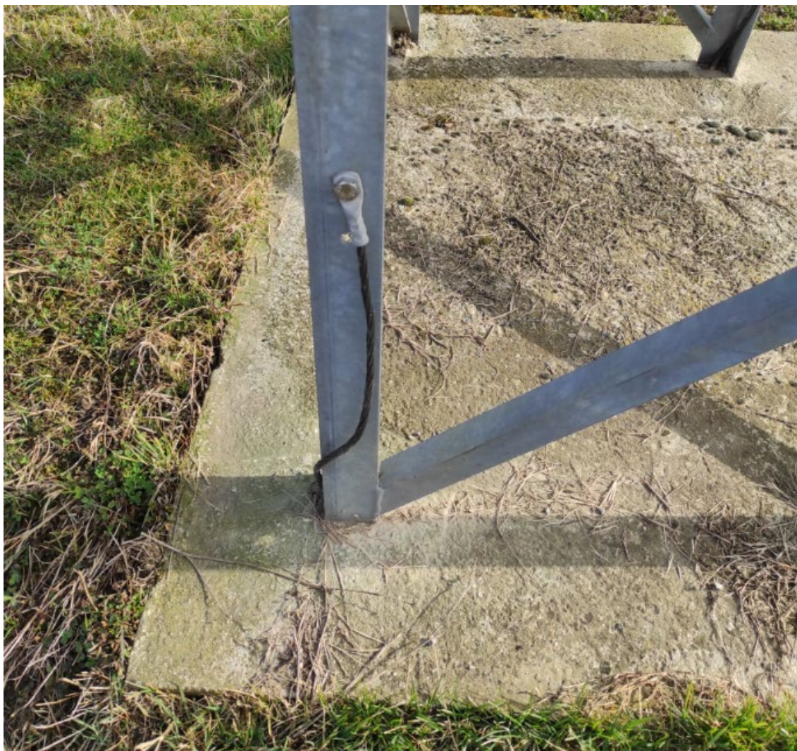
Slika 6. Uzemljenje na čelično-rešetkastom stupu trafostanice
