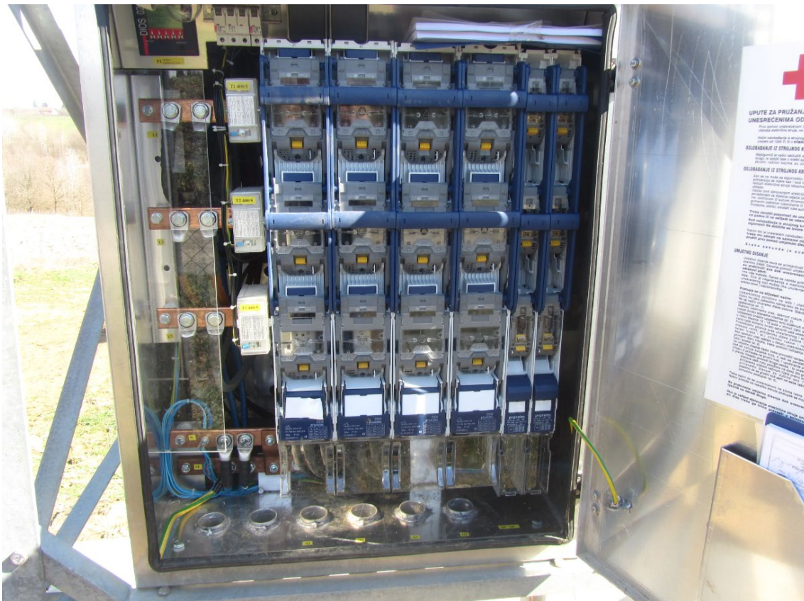
Slika 5 Razvodni ormarić trafostanice za distribuciju
