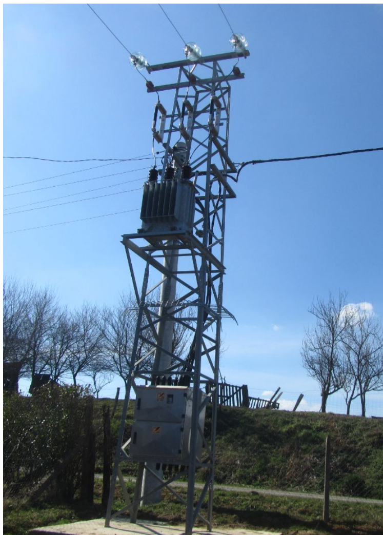
Slika 1 Stupna trafostanica na čelično-rešetkastom stupu
