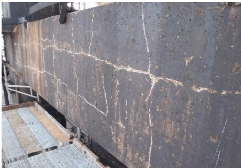
Slika 18. - Pucanje betona uslijed djelovanja požara (dehidracija betona)[33]
