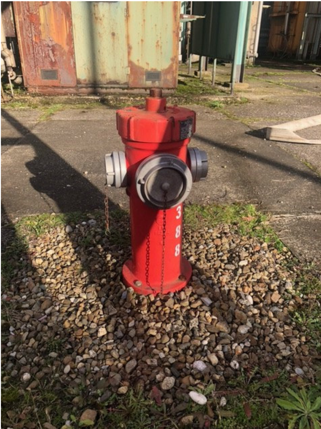
Slika 3. Visoko tlačni nadzemni hidrant [7]
