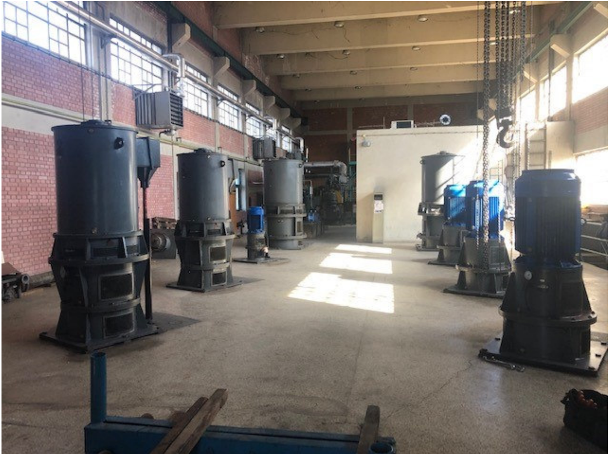
Slika 19. Unutrašnjost pumpaonice s pumpama [7]
