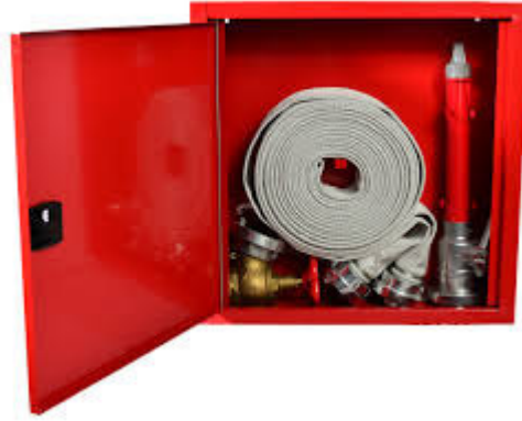
Slika 4. Unutarnji zidni ormarić s opremom [8]
