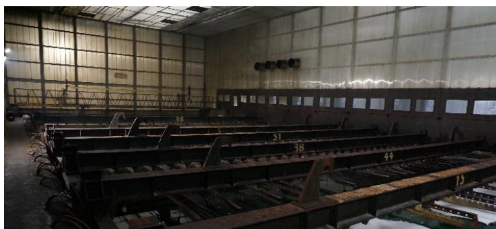
Slika 36. Pogon za predobradu sa vidljivim otvorima za ventilaciju [7]
