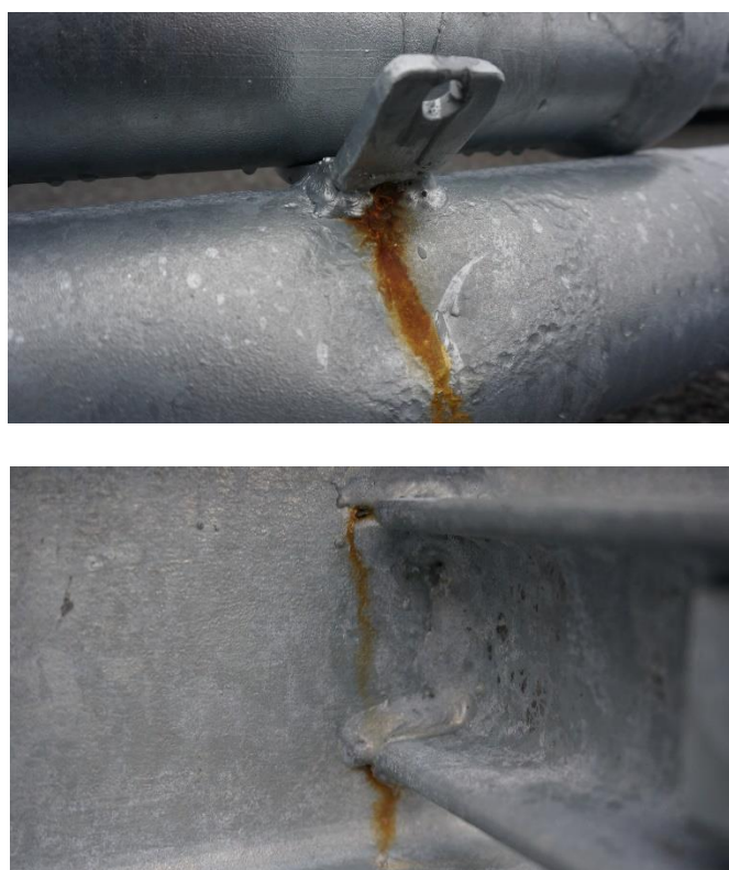
Slika 46. Loše izvedeni zavari[7]
