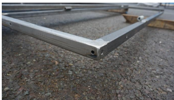
Slika 59. Primjer otvora koji su trebali biti probijeni bliže otvoru (ali to neće utjecati na funkcionalnost elemenata (ali to neće utjecati na funkcionalnost elemenata) [7]
