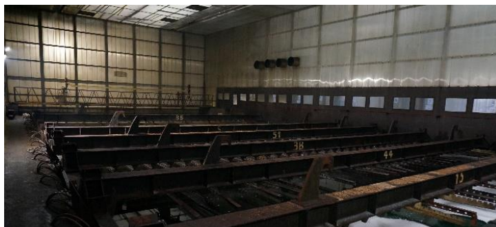
Slika 36. Pogon za predobradu sa vidljivim otvorima za ventilaciju [7]
