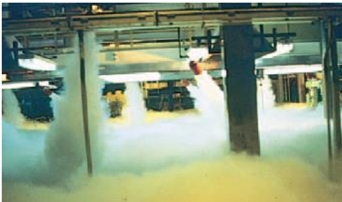
Slika 23. Potpuna zaštita prostora ugljičnim dioksidom
