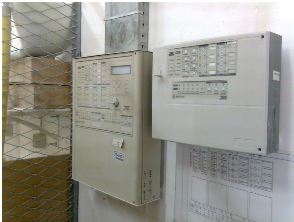
Slika 34. Vatrodojavna centrala u stabilnom sustavu za gašenje požara ugljičnim dioksidom
