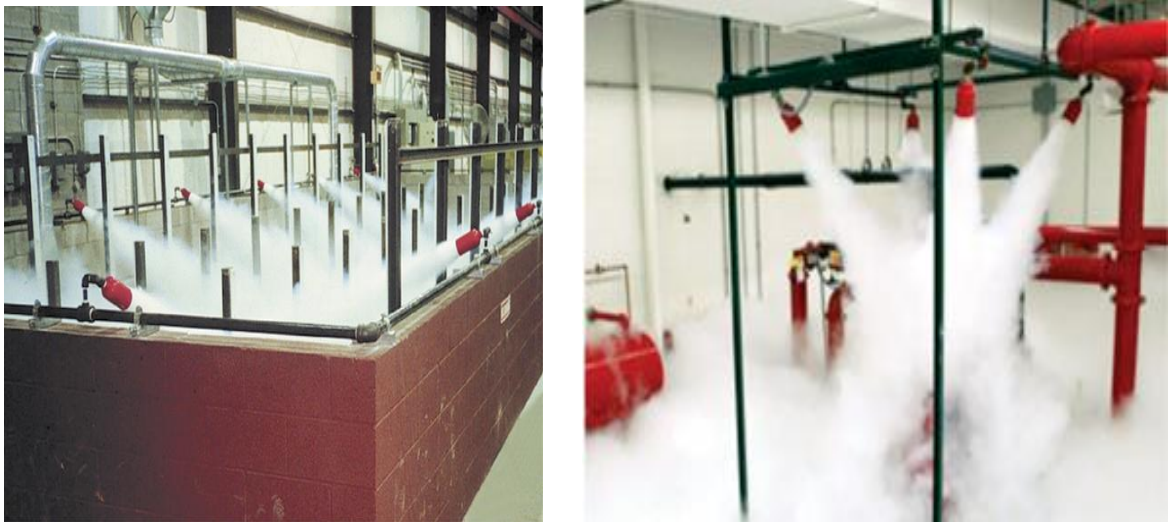
Slika 30. Ispuštanje ugljičnog dioksida na mlaznicama
