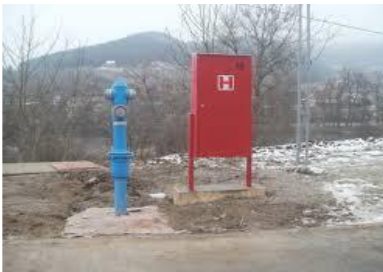
Slika 17. Nadzemni hidrant i ormarić sa opremom
