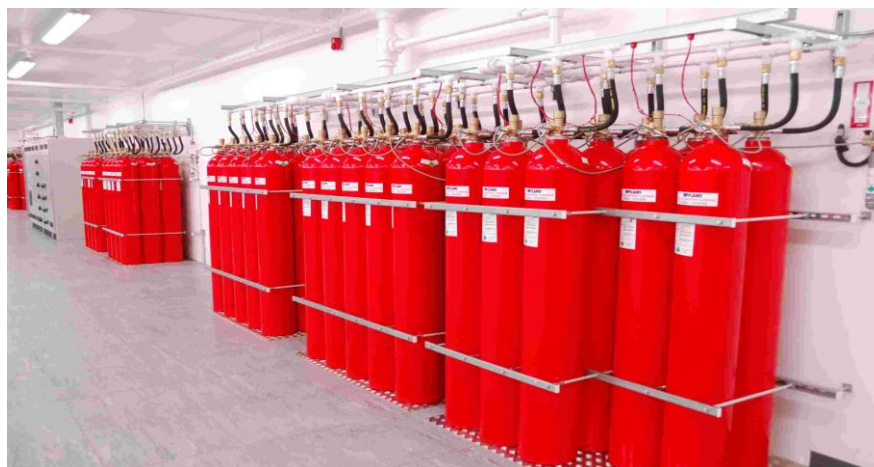
Slika 26. Spremnici (baterije) ugljičnog dioksida u visokotlačnom sustavu za gašenje požara [16]
