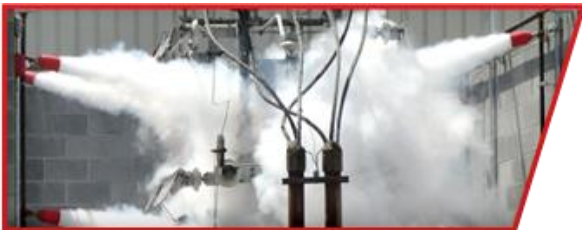
Slika 24. Djelomična zaštita transformatora sustavom za gašenje ugljičnim dioksidom
