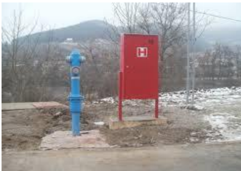
Slika 17. Nadzemni hidrant i ormarić sa opremom
