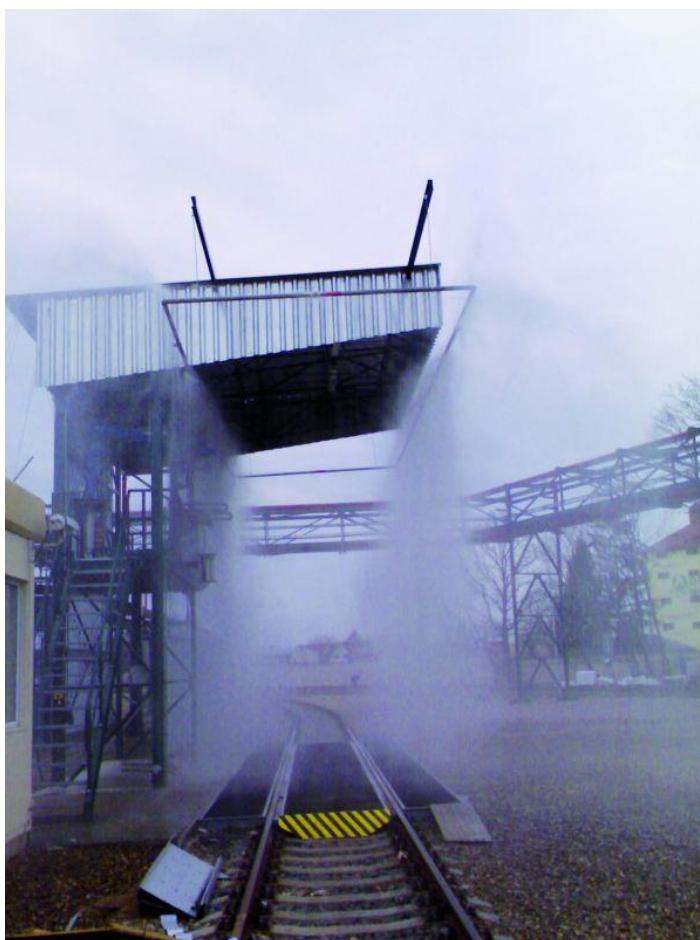
Slika 5. Drencher sustav na pretakalištu za vagon cisterne
