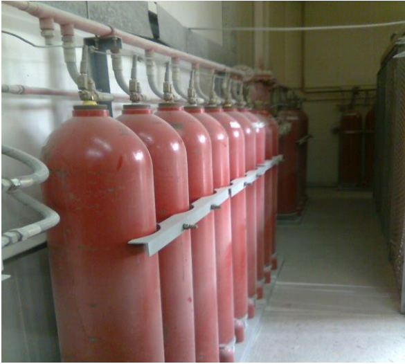
Slika 20. Baterije boca sa CO 2
