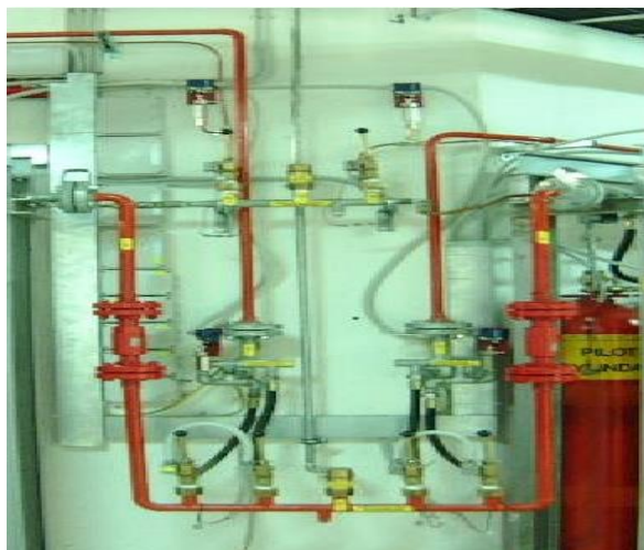
Slika 28. Cjevovod sustava za gašenje požara ugljičnim dioksidom [15]
