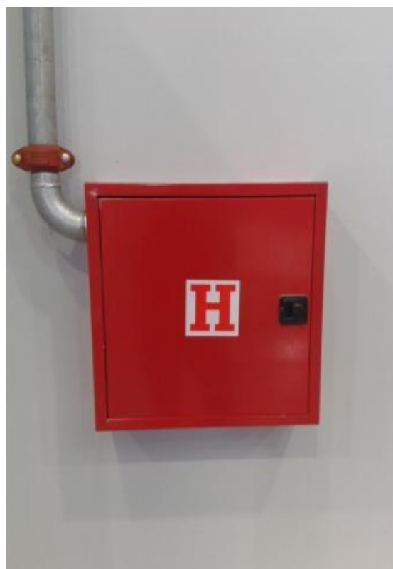
Slika 19. Ormarić unutarne hidrantske mreže
