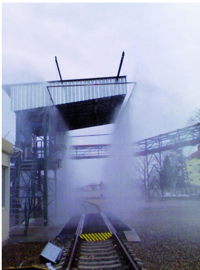
Slika 5. Drencher sustav na pretakalištu za vagon cisterne
