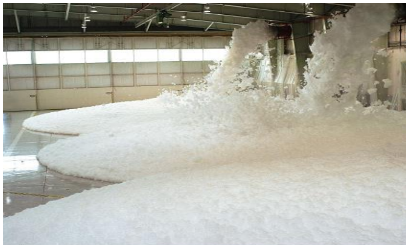
Slika 7. Sustav za gašenje pjenom u hangarima
