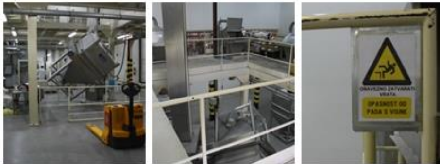
S1.3.2.3. Međukat zaštićen ogradom zbog pada s visine
