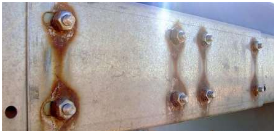
Slika 8. Primjer galvanske korozije
