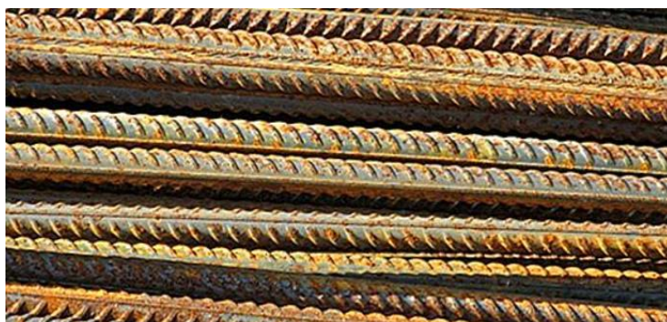
Slika 1: Korozija na armaturnim šipkama [2]
