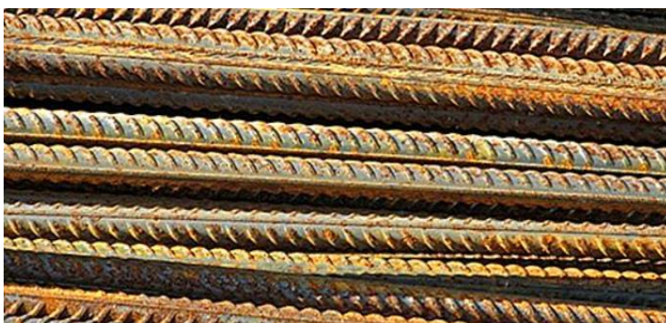
Slika 1: Korozija na armaturnim šipkama [2]
