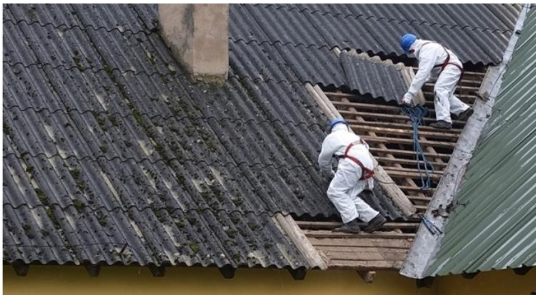
Slika 18. Krovne ploče koje sadrže azbest [36]
