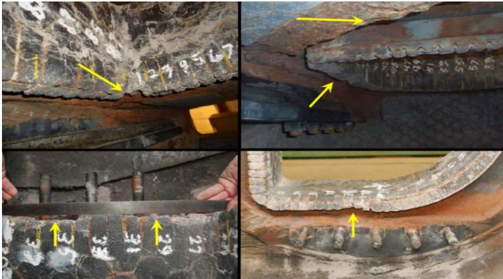
Slika 2. Korozija na ventilu kao uzrok nesreće [9]
