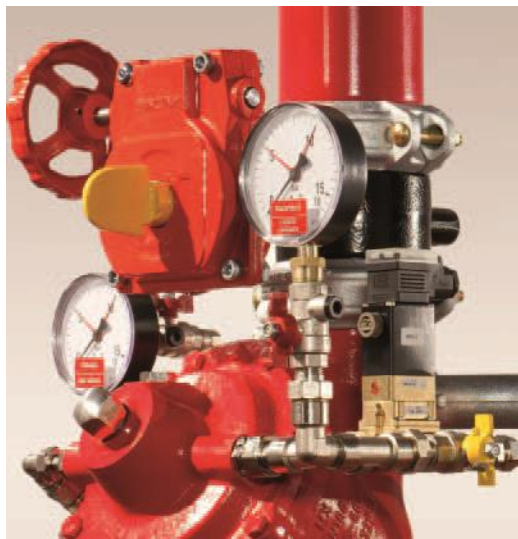
Sl. 6. Prikaz drencher stanice [5]
