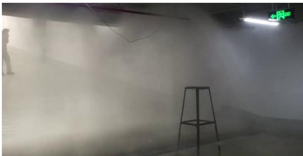
Slika 9. Drencher sustav – vodena zavjesa [7]
