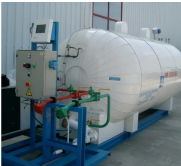
Slika 13. Spremnik niskotlačnog sustava za gašenje požara ugljičnim dioksidom
