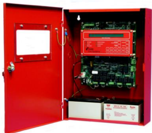
Slika 16. Vatrodojavna centrala u stabilnom sustavu [7]
