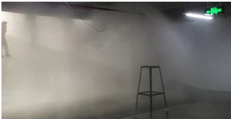
Slika 9. Drencher sustav – vodena zavjesa [7]
