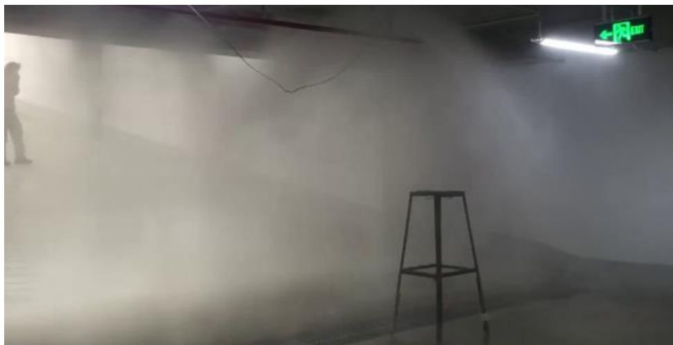
Slika 9. Drencher sustav – vodena zavjesa [7]
