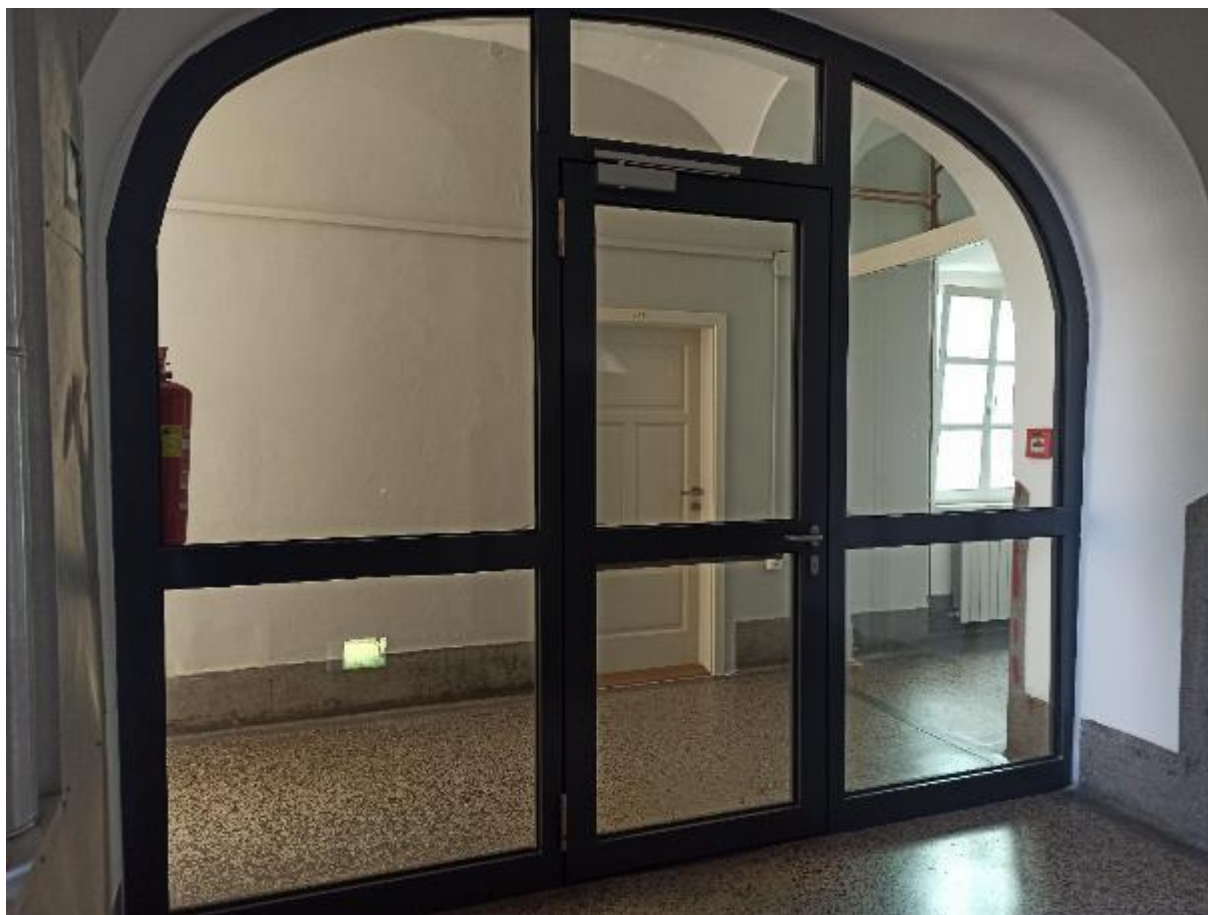
Slika 13. Primjer protupožarnih vrata i stakla na prijelazu požarnog sektora [14]
