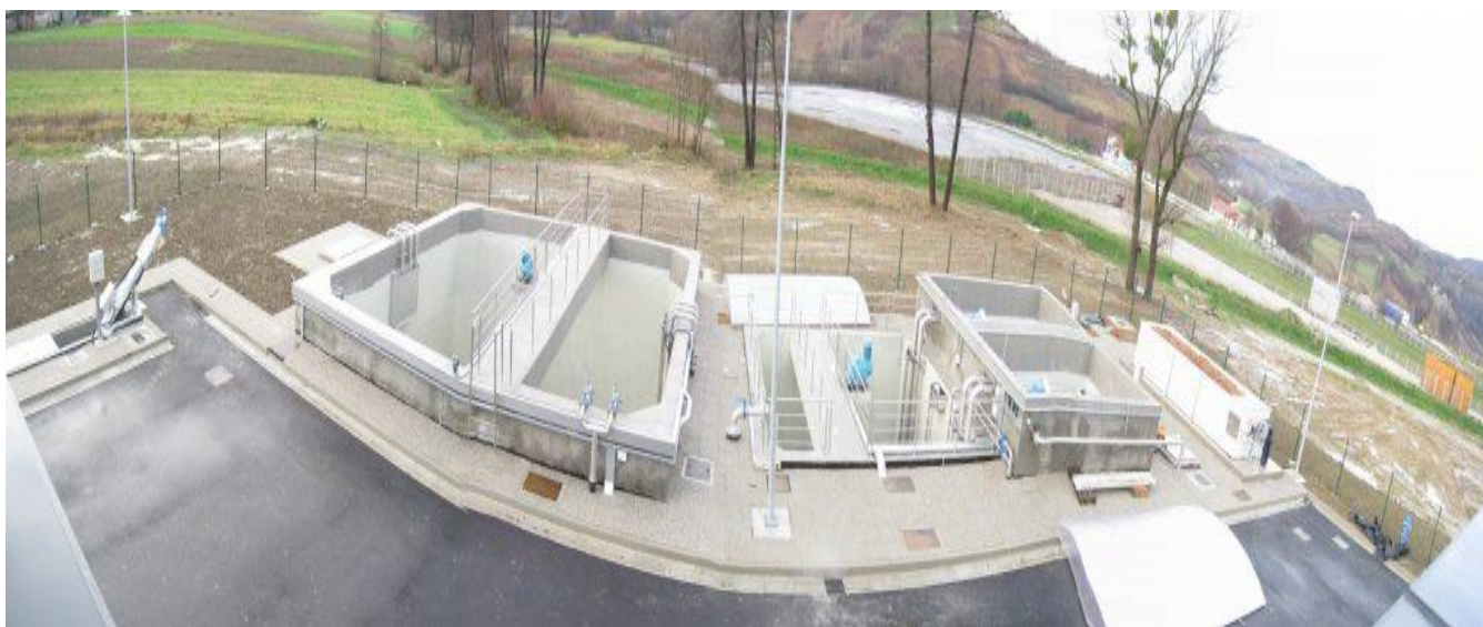
Slika 7: uređaj za pročišćavanje otpadnih voda Jamnica [19]
