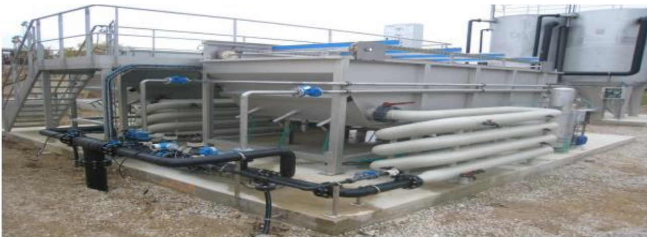
Slika 2: Tehnologija za pročišćavanje otpadnih voda u prehrambenoj industriji i industriji pića [7]
