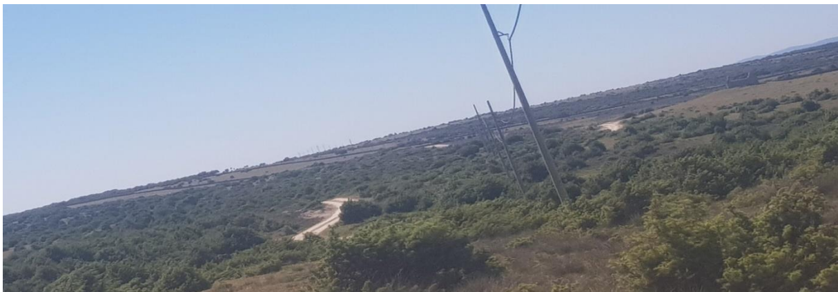
Slika 11: Kablirani dio dalekovoda na Cresu
