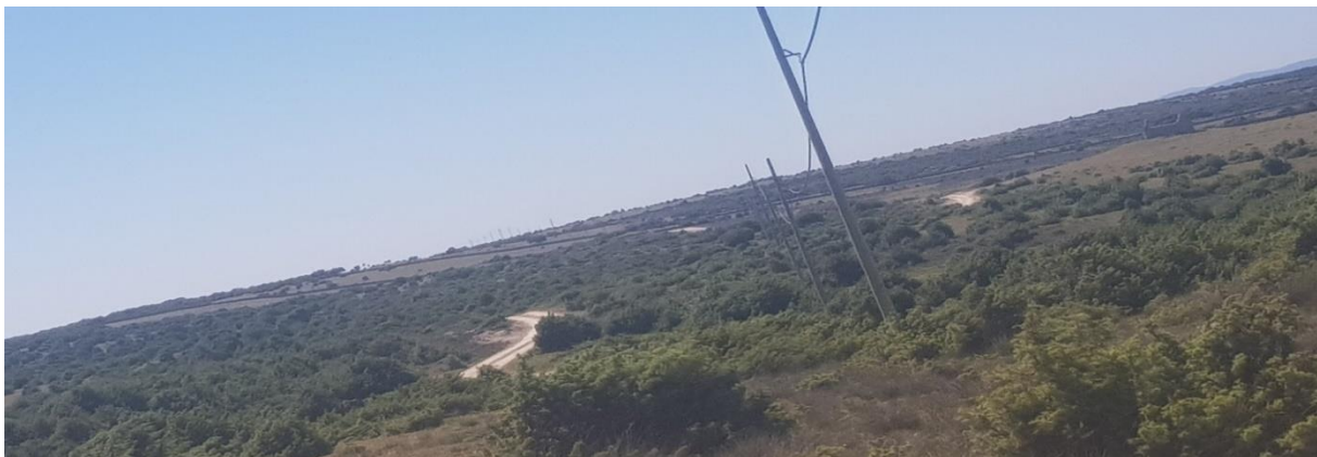
Slika 11: Kablirani dio dalekovoda na Cresu
