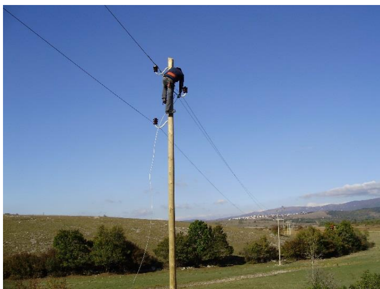
Slika 8. Nadzemni 10(20) kV dalekovod [12]
