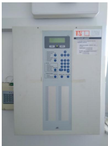
Slika 16: Alarmna centrala 1 Izvor: autorica
