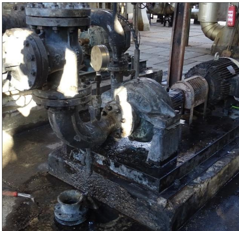
Slika 12. drenaža pumpe 321 MP-012A nakon požara [4]
