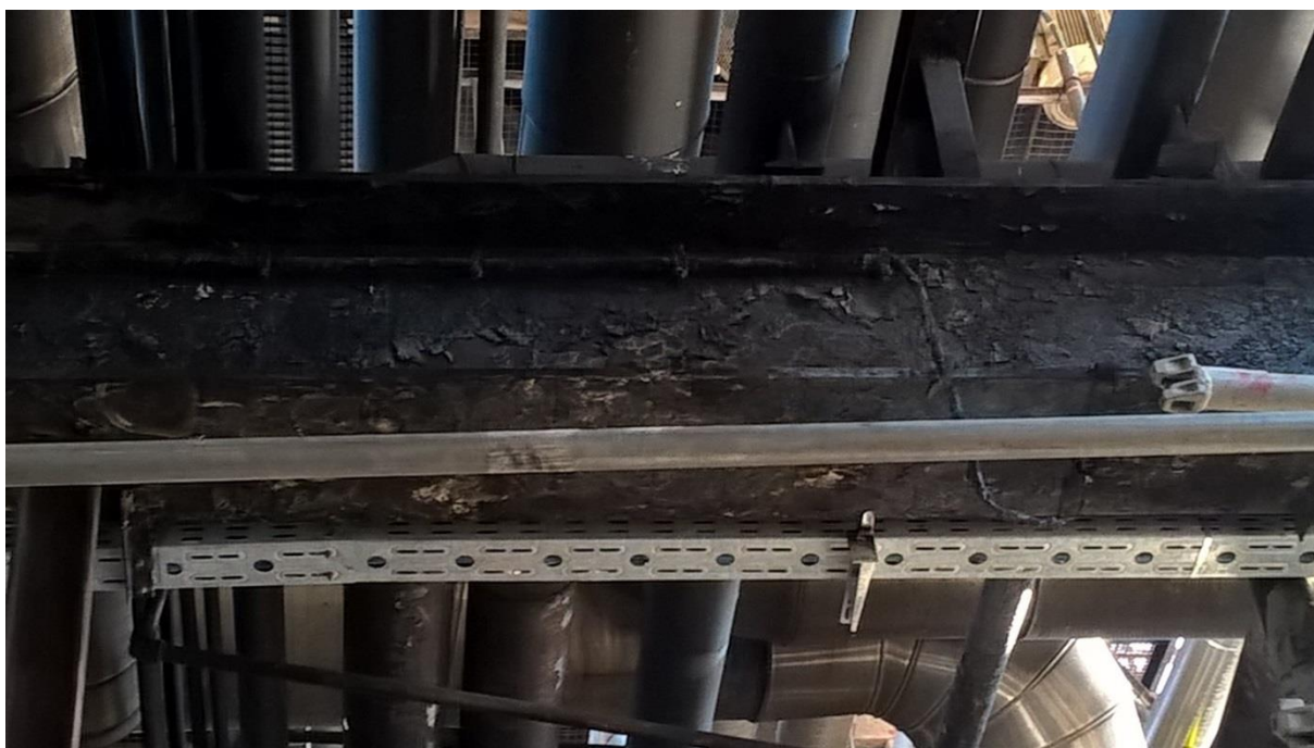
Slika 9. Mjesta na konstrukciji koje je zahvatio požar – izolacija [4]
