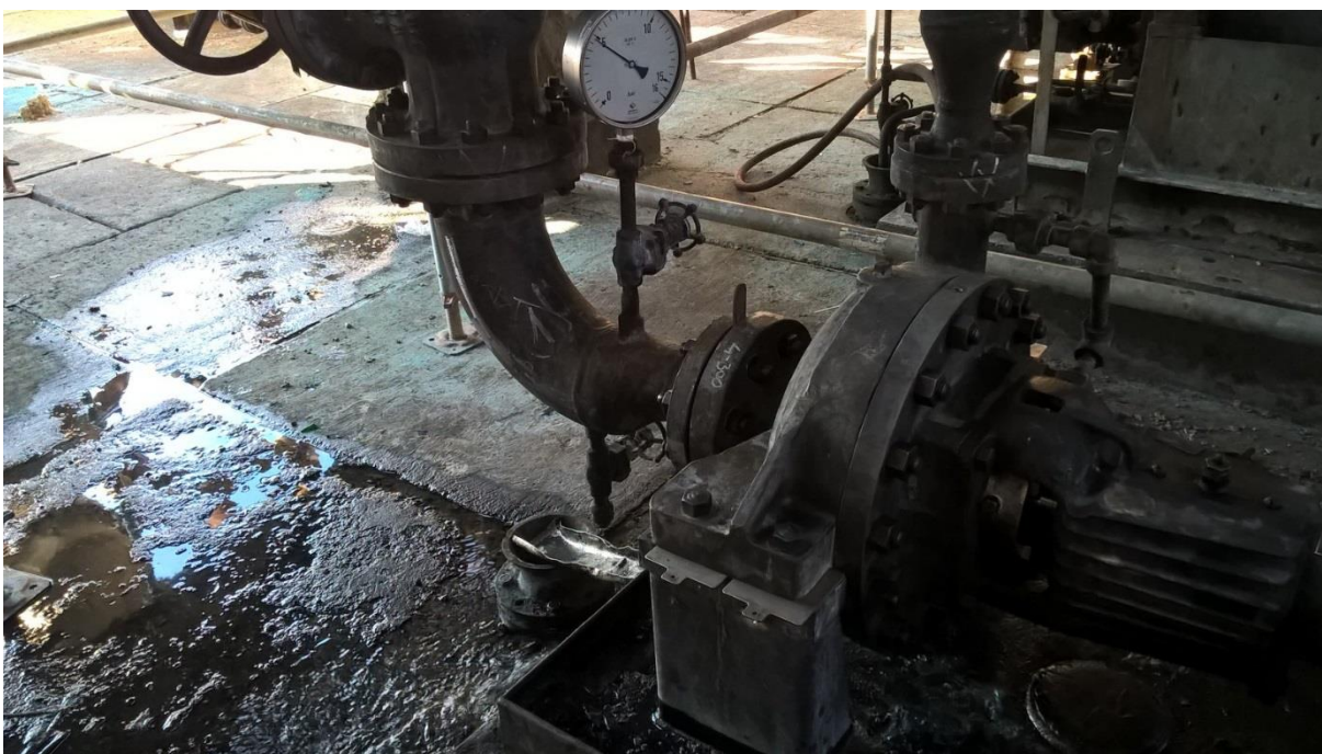
Slika 7. Pumpa ukapljenog naftnog plina 321 MP-012A sa mjestom požara [4]
