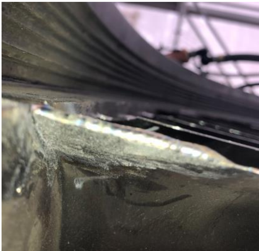
Slika 30. Pogled na donju stranu zavara nakon brušenja
