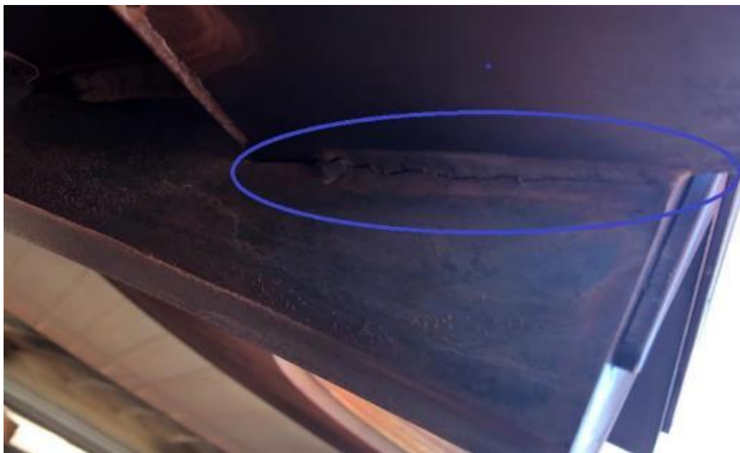
Slika 23. Pogled na pukotinu s donje strane
