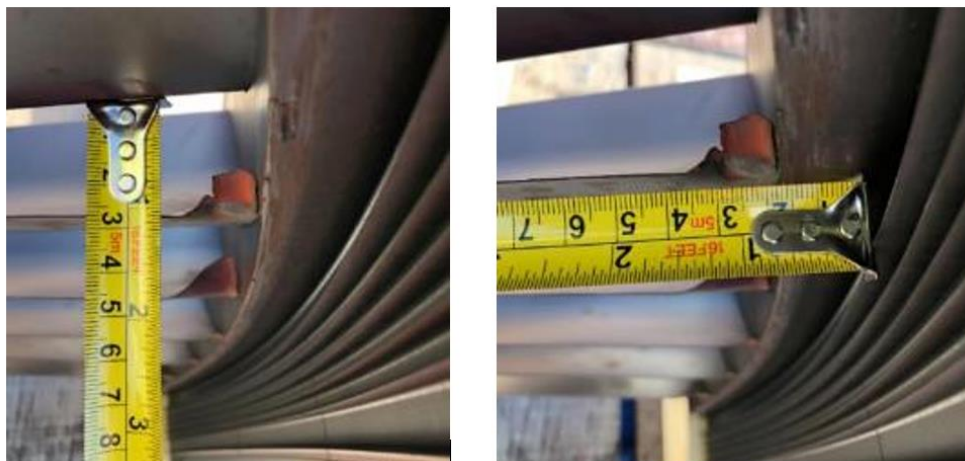
Slika 21. Utvrđivanje veličine oštećenja
