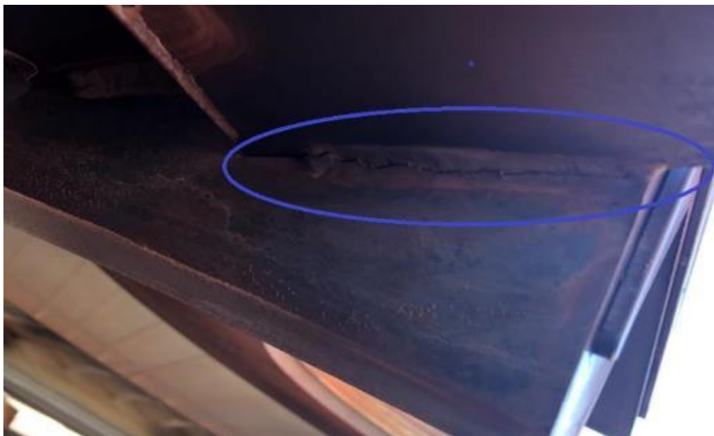
Slika 23. Pogled na pukotinu s donje strane
