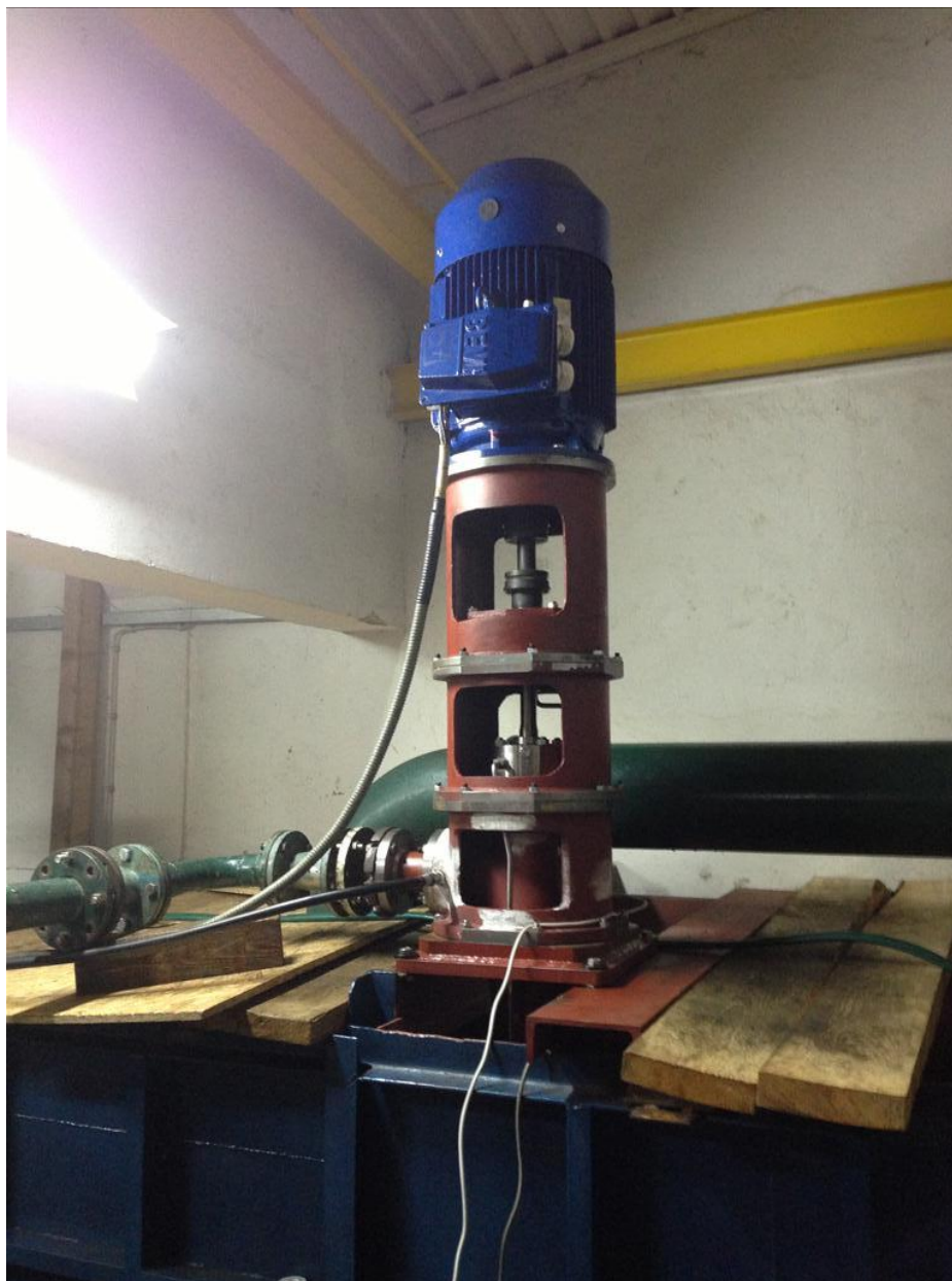
Slika 4. Ispitivana pumpa na spremniku ispitne stanice [9]
