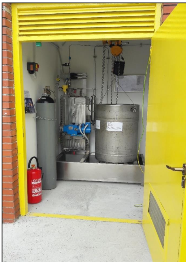
Slika 11. Plinska odorizacijska stanica
