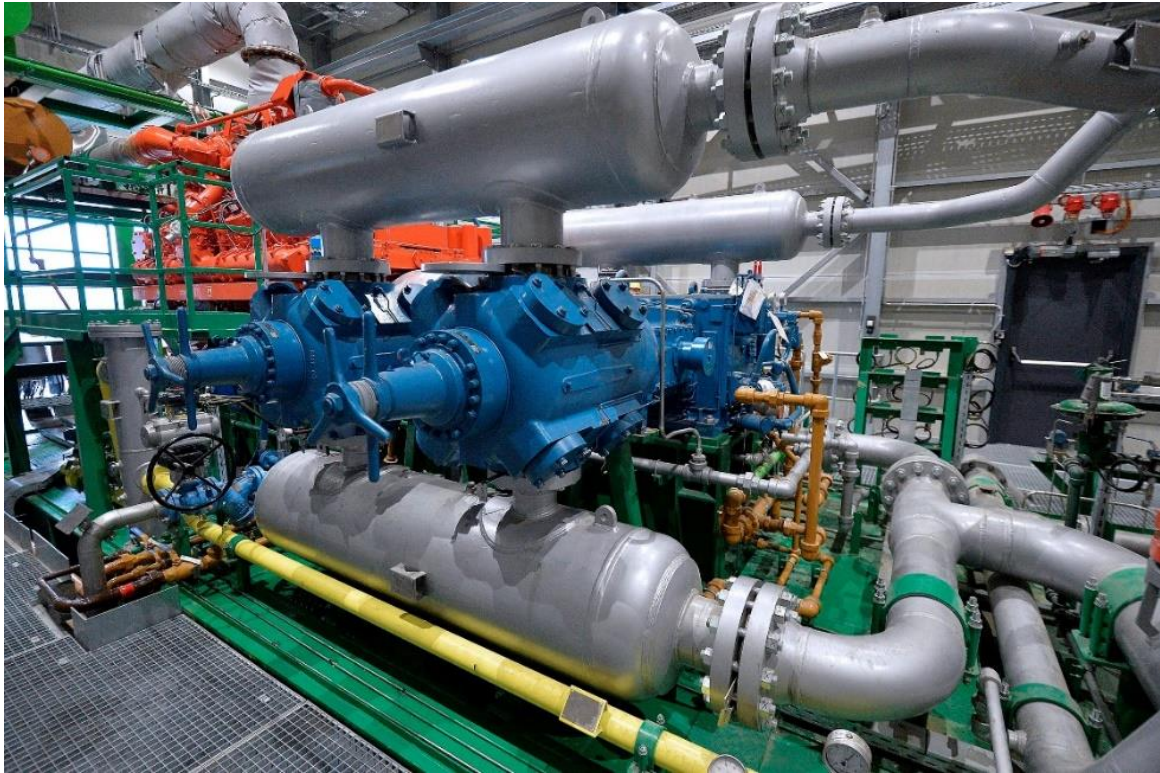
Slika 5. Kompresorska stanica na plinskom transportnom sustavu
