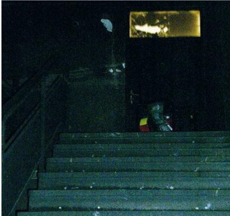
Sl. 16. Stubište zgrade zahvaćeno požarom [21]
