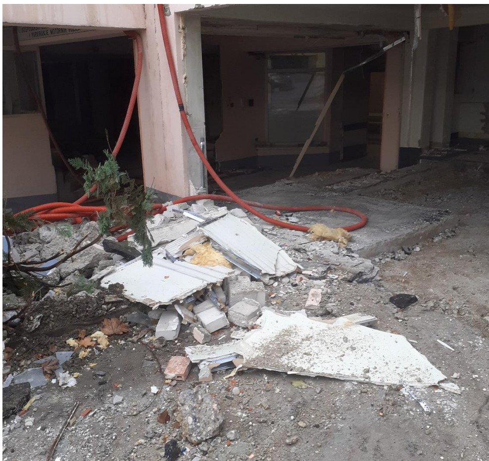
Slika 17. Šuta oko zgrade
