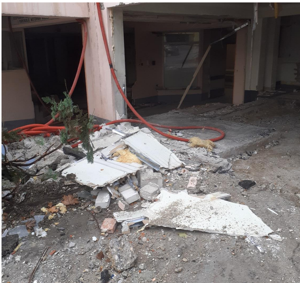
Slika 17. Šuta oko zgrade
