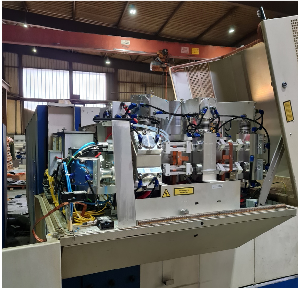
Slika 25. Izmjena vode i čišćenje rashladnog sustava rezonatora
