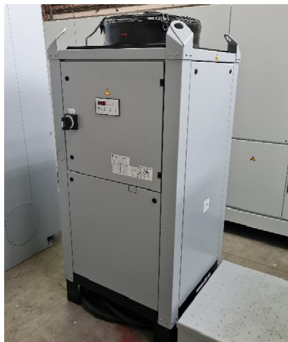
Slika 14. Izgled rashladnog agregata
