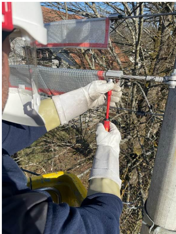
Slika 19. Spajanje priključnog kabela svjetiljke na zračni vod s neizoliranim aluminijским vodičima [Vlastiti izvor]
