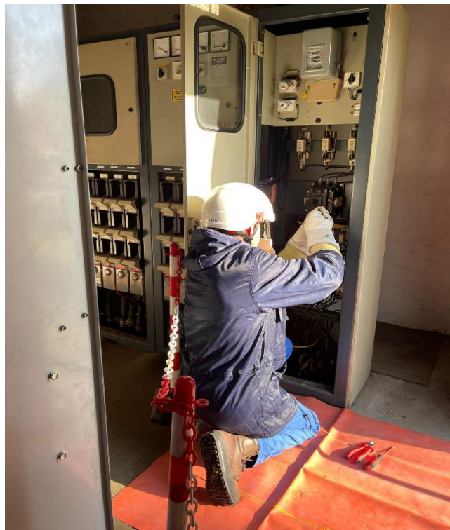
Slika 25. Primjer održavanja ormara JR u trafostanici [Vlastiti izvor]
