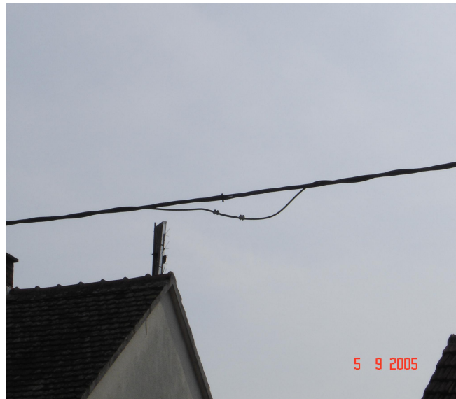
Slika 20. Primjer oštećenog vodiča [Vlastiti izvor]
