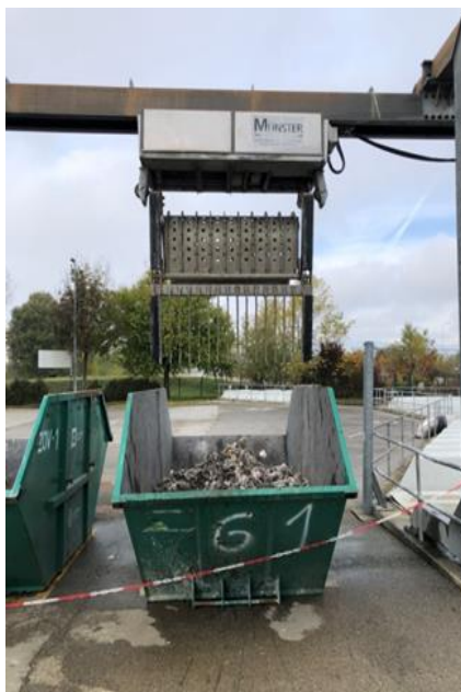
Slika 5. Grube rešetke za odvajanje papira iz otpadnih voda
