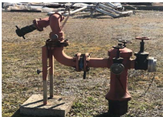
Slika 15. Stabilni bačaci vode na SRU.[5]
