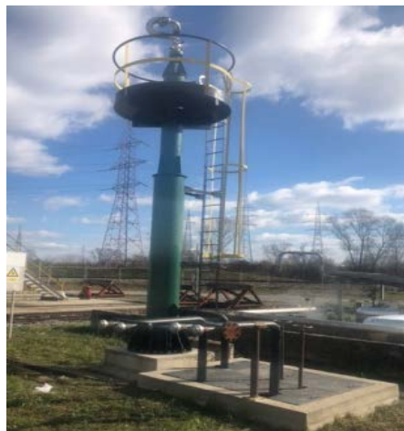
Slika 14. Stabilni bacači voda/pjena na MM2.[5]
