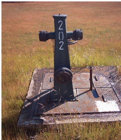
Slika 19. Nadzemni hidrant tipa RNS.[5]
