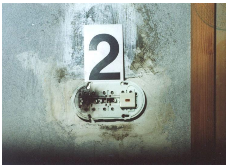
Slika 23. Karbonizacijsko začađenje na višestrukom prekidaču [12]
