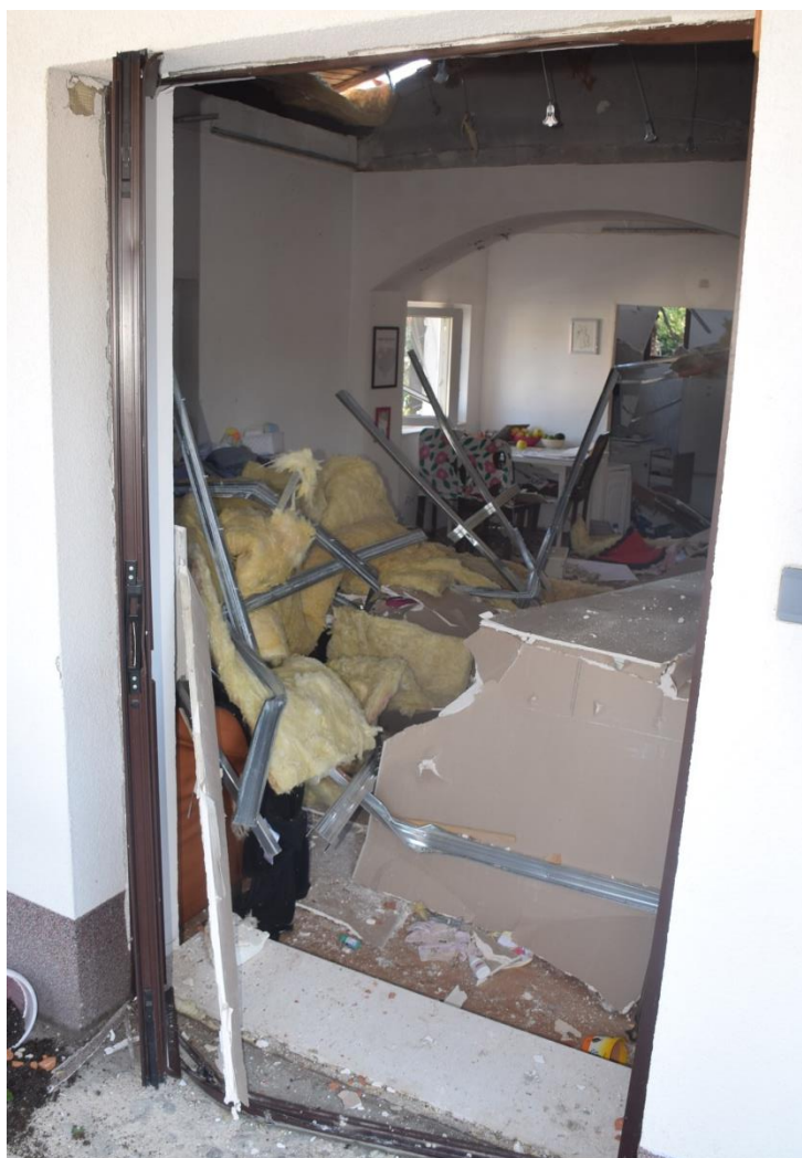
Slika 39. Vrata izvan ležišta te puknuto krovništvo [18]
