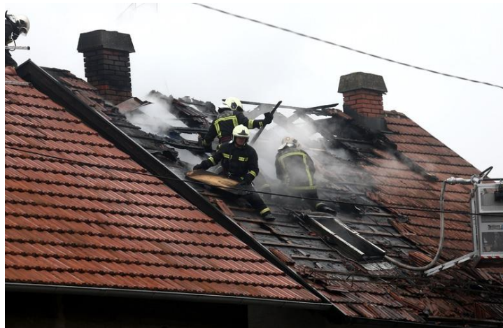
Slika 6. Gašenje drvene konstrukcije krova [10]
