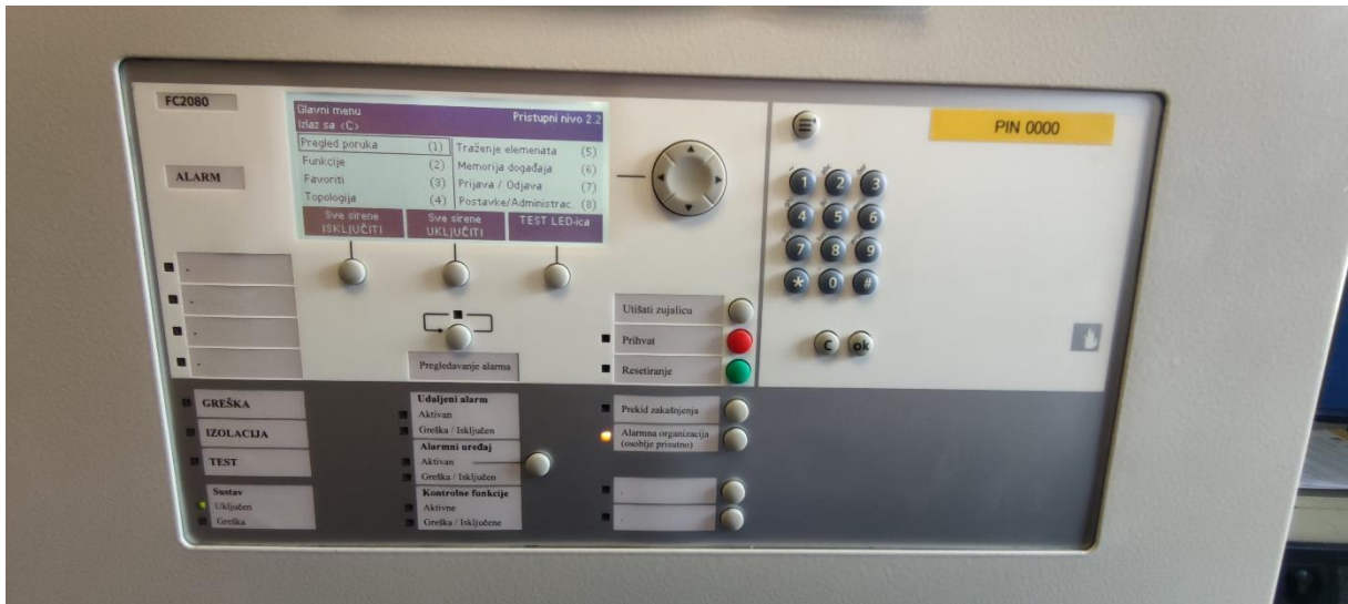
Slika 3. Uvećani prikaz vatrodojavne centrale (Izvor: Autor)
