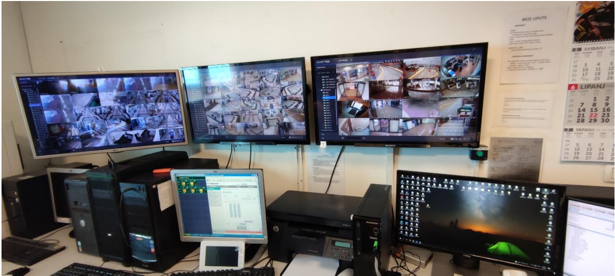
Slika 6. Prikaz kontrolne sobe na 6. katu (Izvor: Autor)
