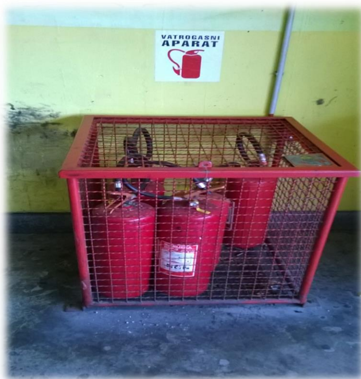
Slika 10. Ormarić s aparatima za početno gašenje požara u garaži (Izvor: Autor)
